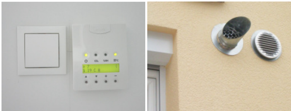
Abbildung 24: Links : Bedienelement des Lüftungsgerätes und Stoßlüftungstaster. Die Taster „CO 2 “ und „%RH“ sind bei den Geräten ohne Funktion. Rechts : Außen- und Fortluftelemente auf der Fassade.
