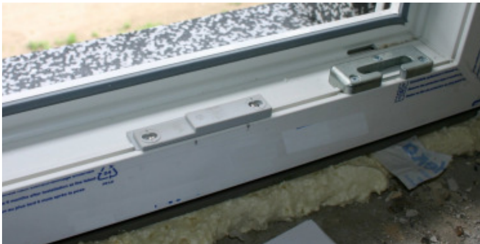
Abbildung 70: Kontaktelement im Blendrahmen zur Erfassung der Fensteröffnungsvorgänge. Betätigung durch Magneten am Beschlag des Flügelrahmens.
