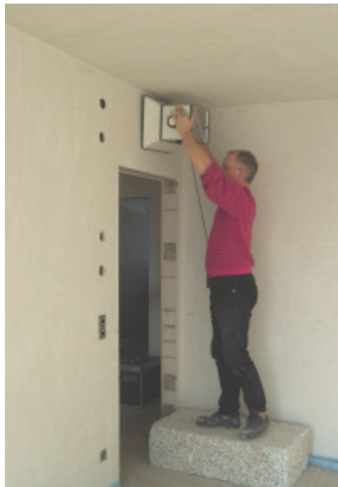
Abbildung 59: Volumenstrommessung an einer Zuluftdüse im Wohnzimmer einer Wohnung des PHiB vor Fertigstellung der Gebäude.
