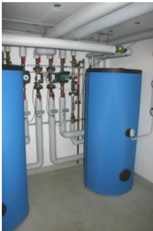
Abbildung 137: Die beiden Warmwasserspeicher und die vier zentralen Wärmemengenzähler für Warmwasser- und Zirkulationswärmemengen im Übergabekellerraum von Haus 5.
