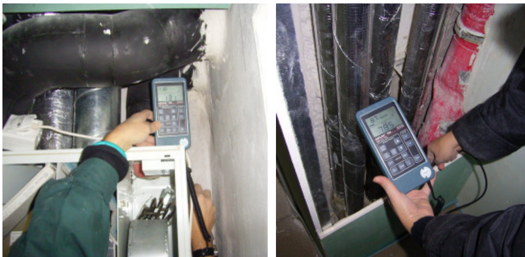
Abbildung 30: Links : Leckagen an der Durchführung der Lüftungsrohre durch die Außenwand. Rechts : Leckage am Verguss der Rohrleitungsdurchführung zum Keller.
