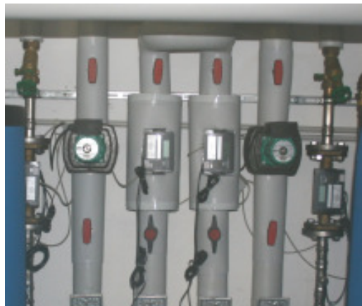
Abbildung 64: Wärmemengenzähler für Warmwasser- und Zirkulationsverbrauch im Übergaberaum (Haus 5) nach erfolgter Wärmedämmung der Rohrleitungen.
