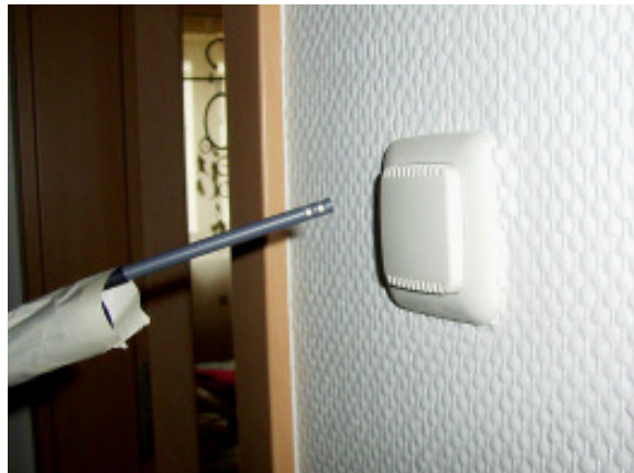
Abbildung 67: In situ Kalibriermessung eines Temperatursensors. Links im Bild der Referenztemperatursensor.
