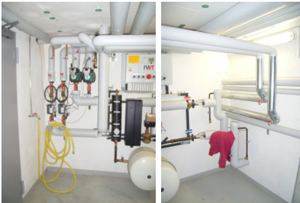
Abbildung 20: Westwand des Nahwärmeübergaberaumes mit der Nahwärmeregulierung, dem Wärmeübertrager und den Heizkreispumpen. Die beiden Erdleitungen werden durch die Außenwand in den Raum eingeführt (rechts im Bild).
