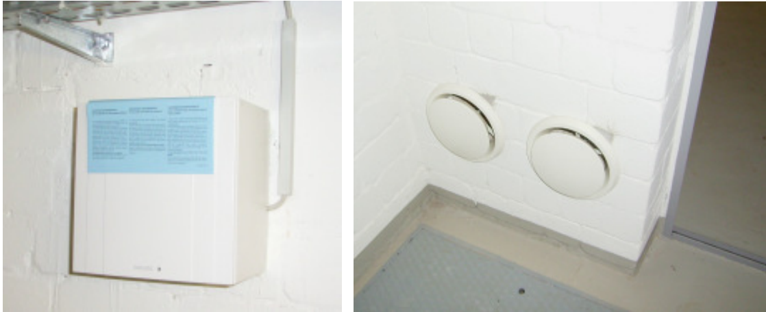
Abbildung 150: Abluftventilator im Keller von Haus 1 und Haus 3 (links) und Überströmelement in der Wand von dem Kellerraum zum Kellerflur (rechts).
