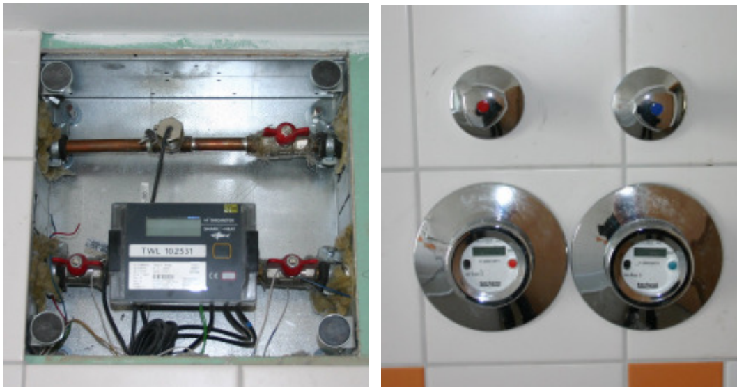
Abbildung 65: Wärmemengenzähler Heizwärme und Wasseruhren (Kalt-/Warmwasser) im Bad jeder Wohneinheit (Bauphase).
