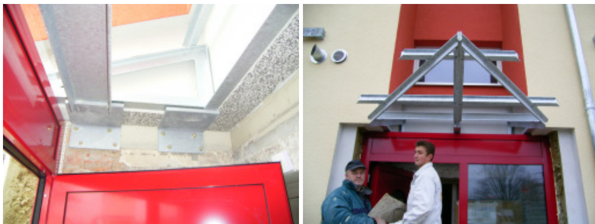
Abbildung 11: Montage eines der Vordächer über dem Eingangsbereich im Fassadenrückprung. Die verbleibende Wärmebrücke ist in der Energiebilanz berücksichtigt.
