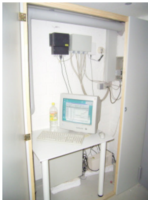
Abbildung 61: Messzentrale im Keller von Haus 5 (NEH).
