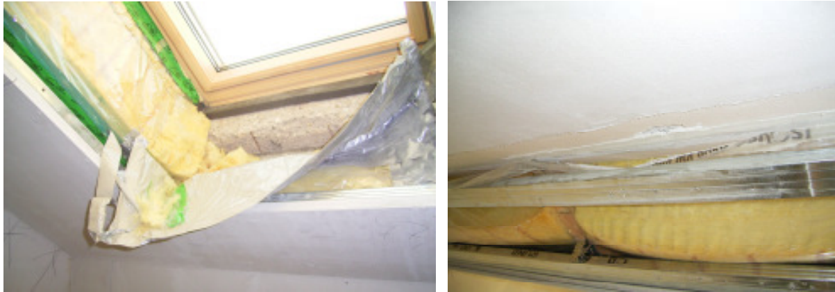
Abbildung 28: Links : Nicht fachgerecht verklebte luftdichte Ebene und Wärmebrücke im Bereich der Fensterlaibung im Treppenhauskopf. Rechts : Abgelöste (transparente) Folie bei der Innendämmung im Treppenhauskopf durch nicht fachgerechten Untergrund und durch zu große Spannungen auf die Folie durch das Gewicht der Dämmung.
