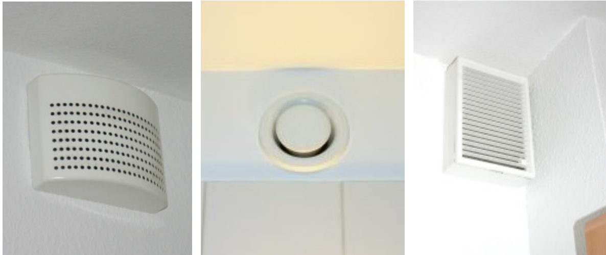
Abbildung 25: Zuluftventil Wohn- und Schlafzimmer, Abluftventil Bad und Abluftventil mit einfach demontierbarem Fettfilter in der Küche (von links nach rechts). Der Fettfilter aus Edelstahl sollte durch die Bewohner selber regelmäßig, nach Sichtkontrolle, gereinigt werden (Abspülen/ Spülmaschine).
