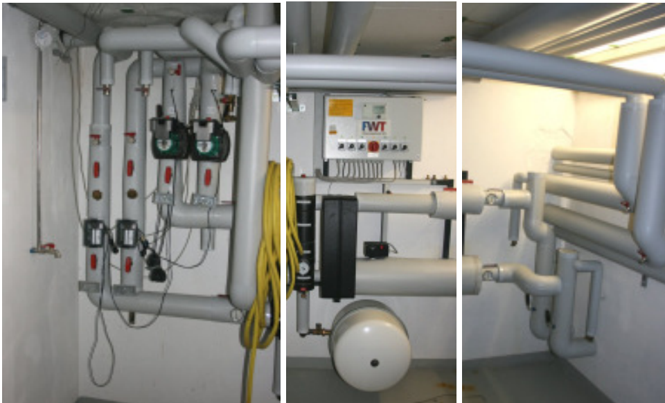
Abbildung 58: Installationswand im Nahwärmeübergaberaum mit Übergabestation, Heizkreispumpen, Wärmeübertrager und WMZ.
