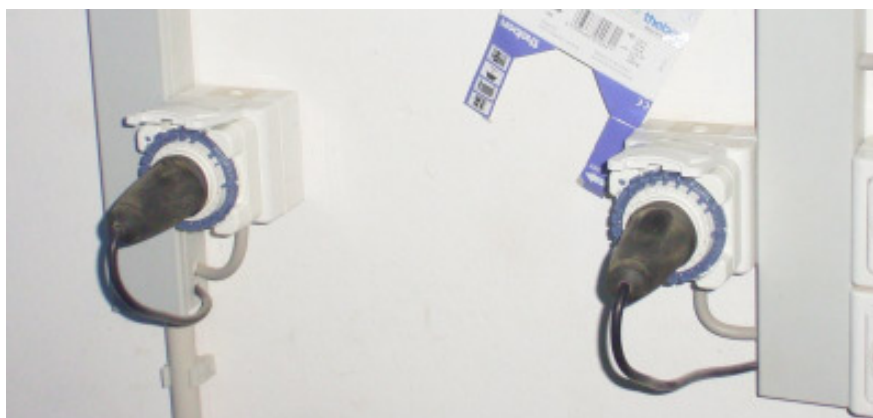
Abbildung 141: Montierte handelsübliche Tagesschaltuhren zur Steuerung der beiden Zirkulationspumpen. Diese einfache Zwischenschaltung war möglich, da die Stromversorgung der Pumpen über Steckdosen erfolgt.
