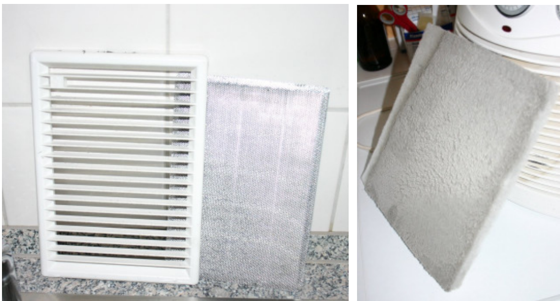
Abbildung 60: Demontierter Fettfilter vom Küchenabluftventil (links) und demontierter, stark verschmutzter Abluftfilter aus dem Lüftungsgerät (rechts).
