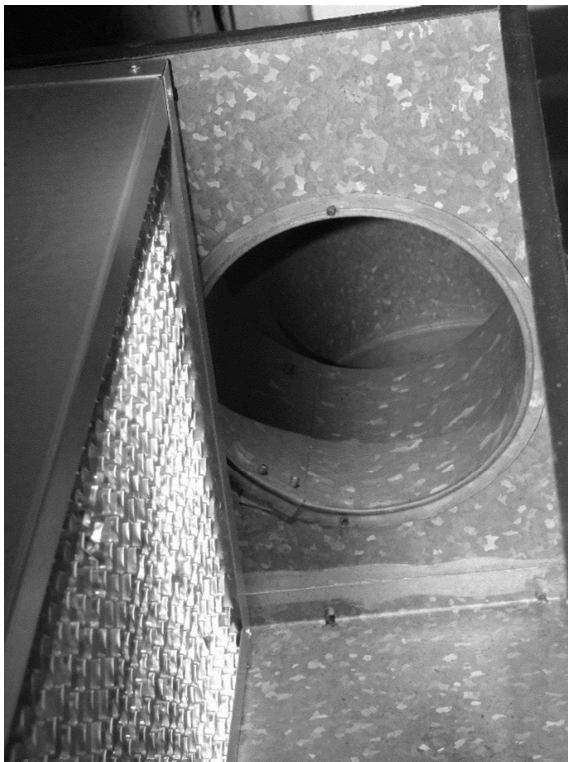
Abbildung 151: Fotodokumentation der Sichtprüfung am Filterkasten
