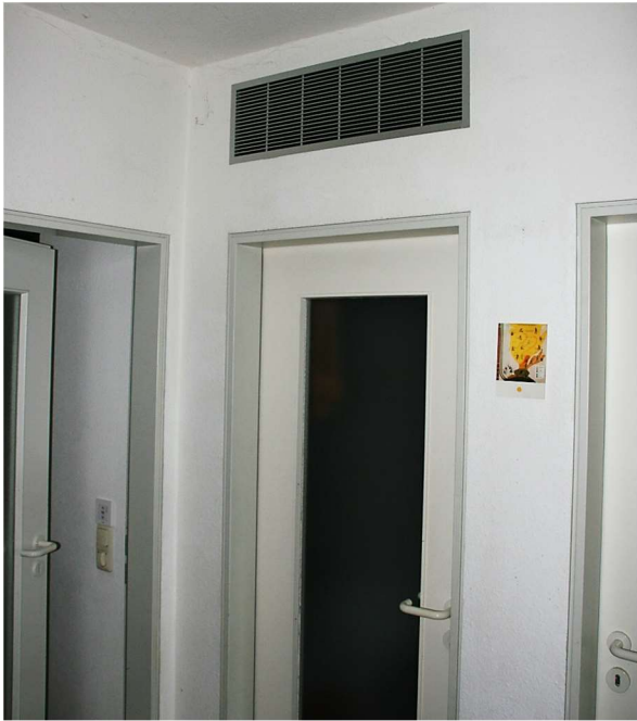
Abbildung 132: Überströmelement oberhalb der Badezimmertür. Für den hier größeren Luftvolumenstrom wurde ein entsprechender Querschnitt vorgesehen. Das Ventil ist im Bad bewusst oben montiert, um Luftströme im Fußbereich zu begrenzen (Komfort im Bad). Der Druckverlust ist außerordentlich gering.
