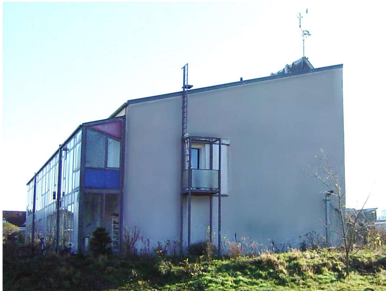
Abbildung 44: Visuelle Aufnahme zur Thermographie der Westwand 1.1.2016
