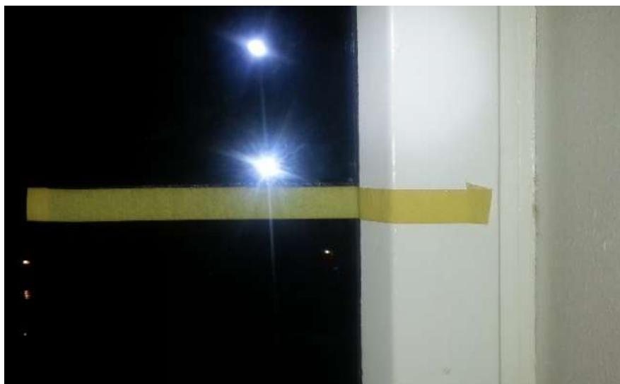
Abbildung 106: Innenthermographie mit hoher Temporauflösung von Verglasung, Fenster- rahmen und Fensteranschluss im Obergeschoss und zugehöriges Lichtbild (unten). Das aufgeklebte Kreppband dient wieder zur ungestörten Bestimmung der Oberflächentemperaturen.
