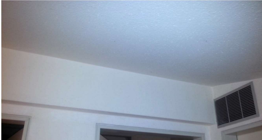
Abbildung 87: Aufnahme im visuellen Spektralbereich: Flur im DG mit Überströmöffnung
