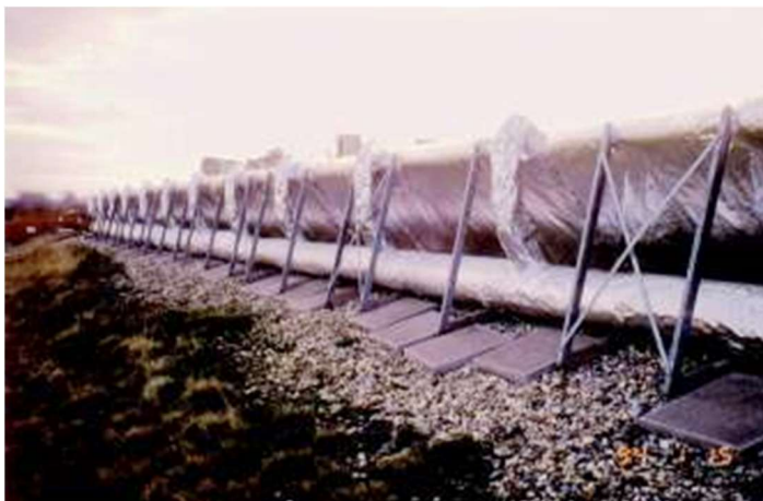
Abbildung 13: Aufgeständerte thermische Solarkollektoren auf dem Dach des Gebäudes.
