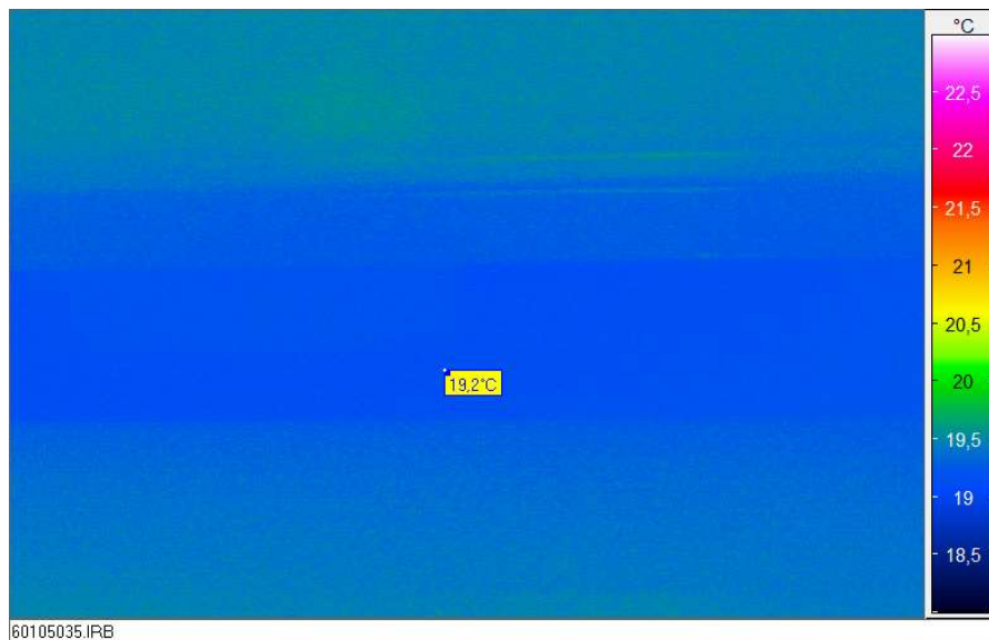
Abbildung 90: Fußboden im EG (Oberseite der Kellerdecke). Erste Treppenstufe der gewendelten Treppe. Die Temperaturdifferenzen sind hier extrem niedrig; auf der Stufe kann in etwa die mittlere operative Temperatur angenommen werden; diese beträgt hier 19,5°C. Der Fußboden liegt an der Oberfläche nur ein Zehntel Kelvin darunter. Der „dunkelblaue“ Streifen dazwischen ist der „thermische Schatten“ der Stufe. Hier sieht der Fußboden die Stufenunterseite (kälter) statt der Wand des Treppenhauses (wärmer) und ist daher geringfügig kühler (19,2 °C).
