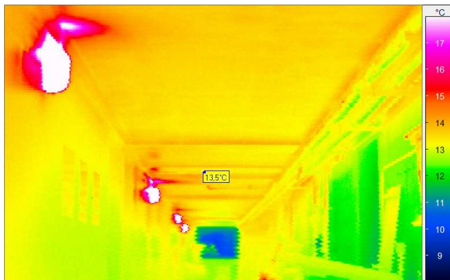
Abbildung 71: Im Mittelgang des Kellers liegen die Raumtemperaturen etwas höher. Die Kellerdecke weist hier an der Unterseite etwa 13,5°C auf. Die etwas wärmeren „Streifen“ sind geometrische Effekte (vertikale Kanten bekommen mehr Zustrahlung von der Decke selbst und weniger vom kälteren Boden). Klar erkennbar sind die Kellerlampen (links) und die von ihnen aufsteigenden Warmluftströme.
