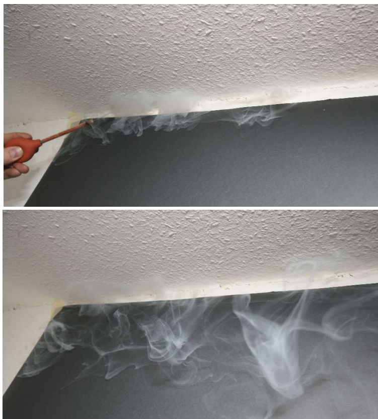
Abbildung 114: „Theaternebel“-Test am Anschluss Dach – Wand bei 50 Pa Unterdruck. In der Nähe des Tapeten-Risses wird Rauch eingeblasen. Es ist keine induzierte Luftbewegung durch einströmender Luft durch den Riss erkennbar. Das untere Bild ist 4 Sekunden nach dem oberen aufgenommen; der Nebel verteilt sich nur ungerichtet. Zur besseren Visualisierung ist ein Bogen schwarze Pappe auf die Wand geklebt worden.
