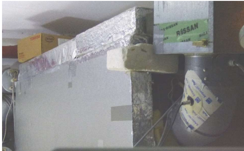
Abbildung 136: Im visuellen Bild ist am unteren Rand die Oberkante des Bildschirms der Thermographiekamera zu sehen. Korrekte Oberflächentemperaturen sind in diesem Bild thermographisch nur an den nicht metallischen und nicht mit Aluminium beschichteten Oberflächen messbar: z.B. auf dem Klebeband (dort Messpunkt) und auf der Oberfläche der Luftdichtungstülle für den Temperatursensor (rechts im Zuluftkanal).
