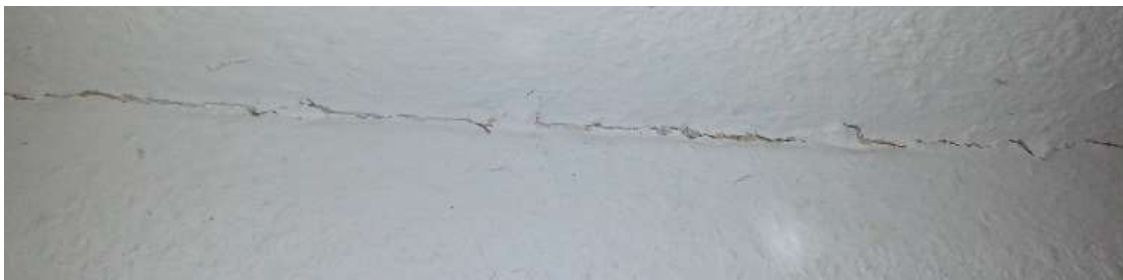
Abbildung 112: Visuelle Aufnahme Tapetenriss an der Anschlussstelle Außenwand/ Dach; Achtung: Das ist nicht die Dichtebene – die liegt darunter in Form der eingeputzten Folie und hält trotz der örtlichen Verschiebung dicht.
