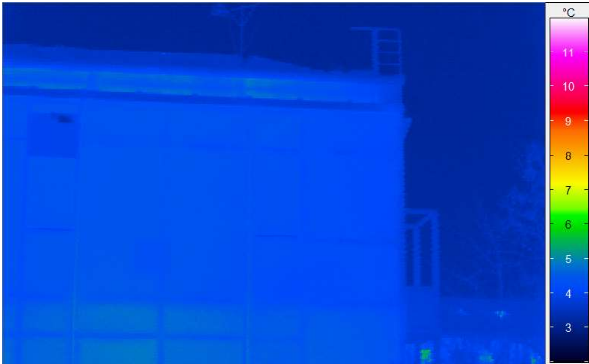
Abbildung 60: Obergeschoss des Glasvorbaus, Nordwestseite am 01.01.2016. Hier ist auch die Dachoberfläche mit einer sehr gleichmäßigen Temperatur von 3,6°C erkennbar. Die Gegenstrahlungstemperatur des Nachthimmels lässt sich zu 3,2°C bestimmen. Die Strahlung stammt aus relativ niedrig liegenden Luftschichten: Es herrschte zum Zeitpunkt der Aufnahme zwar kein Bodennebel, aber die Wolkenuntergrenze lag sehr niedrig.
