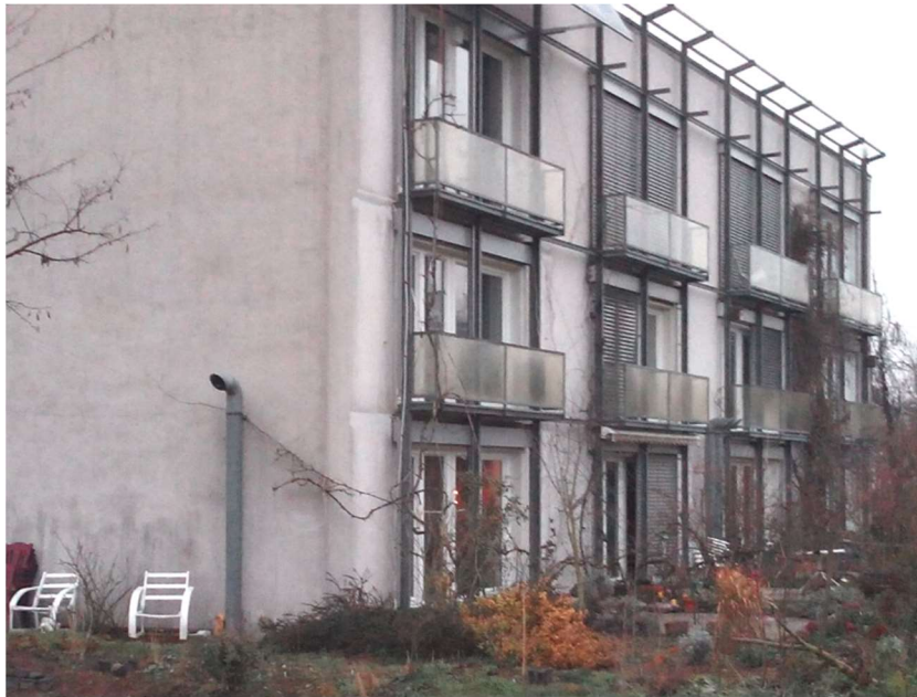
Abbildung 49: Visuelles Bild zur Südwestecke passend zur Thermographie vom 01. Januar 2016
