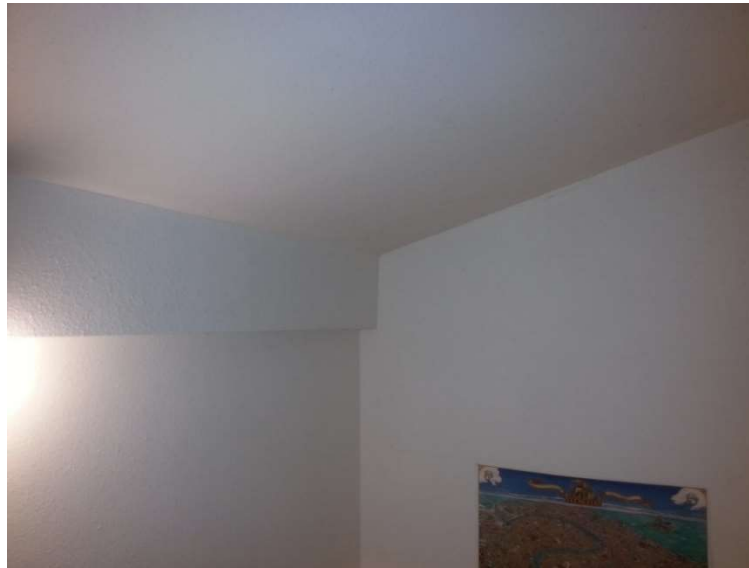
Abbildung 83: Zugehörige visuelle Aufnahme vom Bereichen des Anschlusses Dach/ Trennwand.
