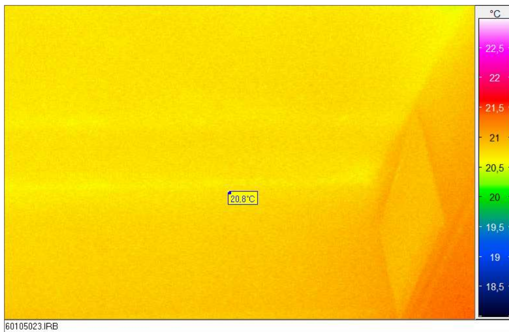
Abbildung 86: Dachanschluss im Flur DG; die Innenwandoberfläche zum Duschbad ist ein wenig wärmer als der Rest der Oberflächen im Flur; die Überströmöffnung für die Abluft hat dagegen erwartungsgemäß Raumlufttemperatur, welche der Temperatur der (leichten) Gipskartonverkleidung des Daches entspricht (20,9 °C). In der vorliegenden hohen Temperaturauflösung sind wieder die Bereiche der Konterlattung mit geringfügig höheren Wärmeverlusten erkennbar.
