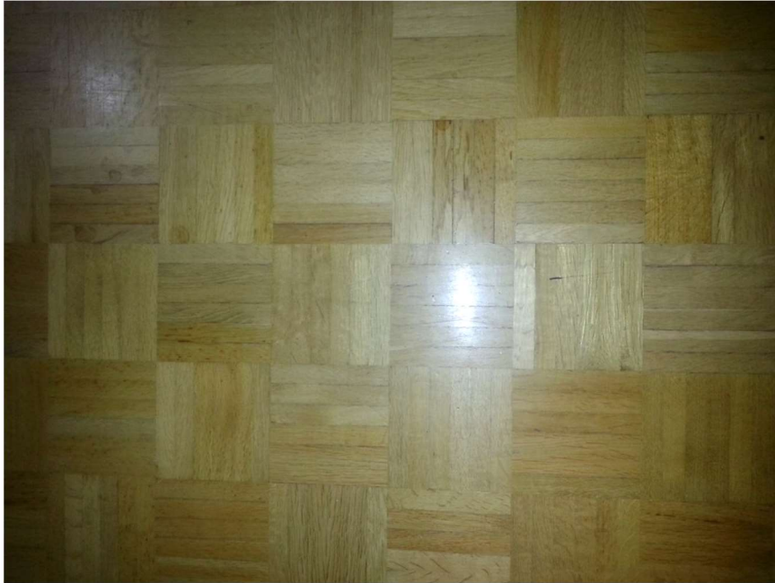
Abbildung 93: Visuelle Aufnahme Fußbodenoberfläche im EG; Beachtenswert: Der gute Zustand des Parketts nach 25 Jahren. Das ist vor allem eine Folge der gleichmäßigen hygrothermischen Bedingungen im Raum.
